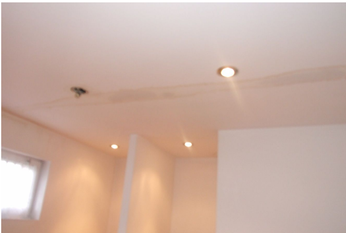
Widok zacieku w łazience
