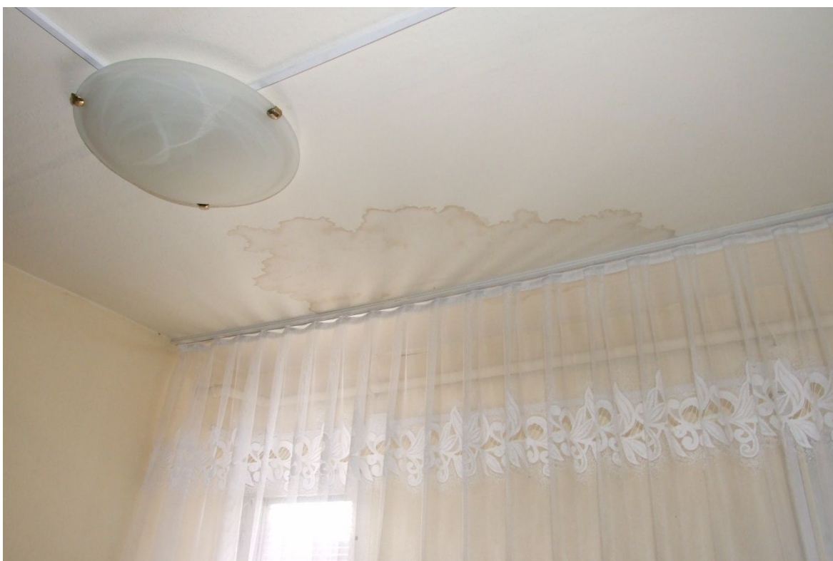
Widok zacieku w pomieszczeniach biurowych
