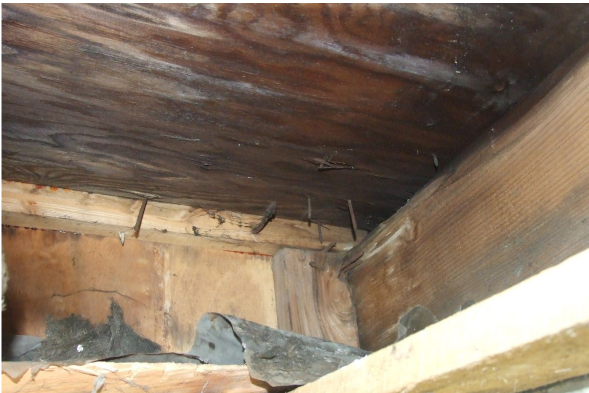
Widok spodu dachu w odkrywc- (widoczne krople ciekącej wody)
